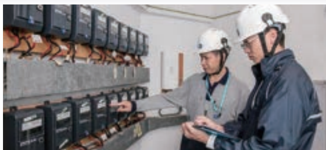
中華電力現正為服務範圍所有客戶安裝智能電錶
